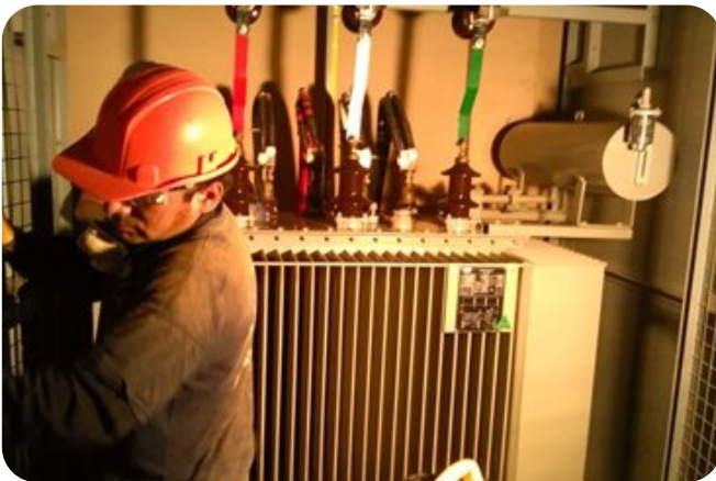
Mantenimiento de Transformador
