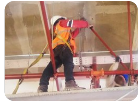
Proyecto: Instalación de Sistema contraincendios
